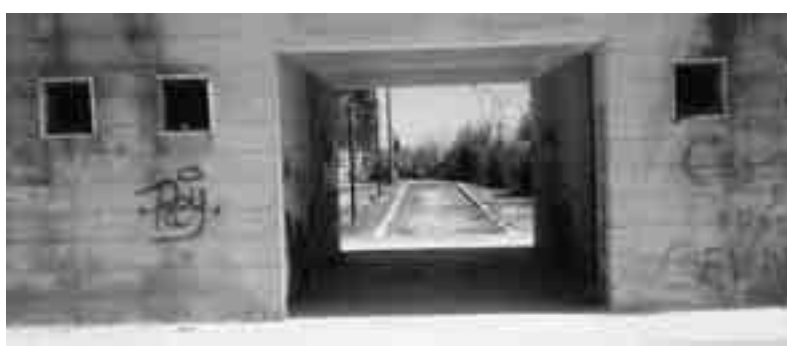
LO STATO DI ABBANDONO E DEGRADO DELL'IMPIANTO SPORTIVO
